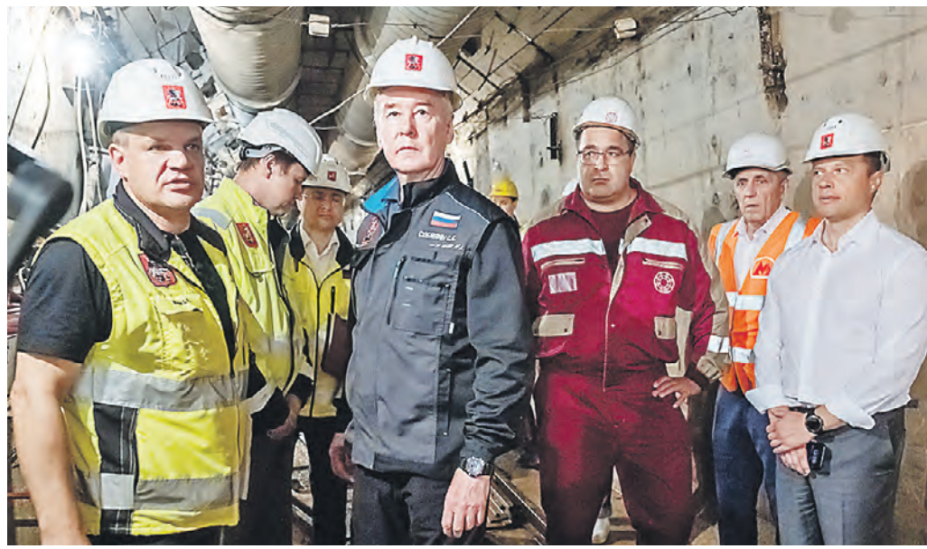
15 июля 2024 года. Мэр Москвы Сергей Собянин (в центре) и заммэра по вопросам транспорта и промышленности Максим Лисутов (крайний справа) общаются со строителями будущей станции «Достоевская» Кольцевой линии метро
